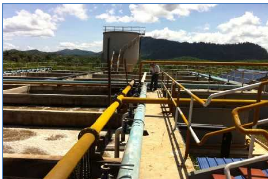
マレーシア・サバ州 SDパームオイル工場 BOD20 排水処理設備 排水量 960m 3 /日 AERATORS1 72sets 導入
