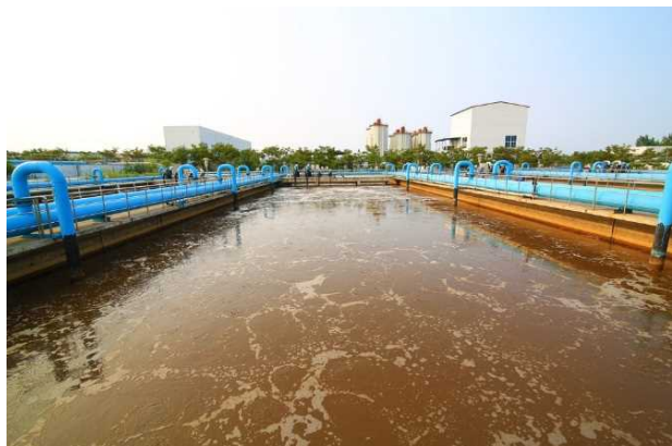
汚水処理設備
