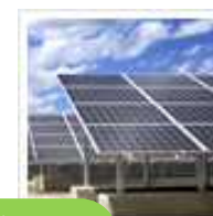
太陽光発電システム
