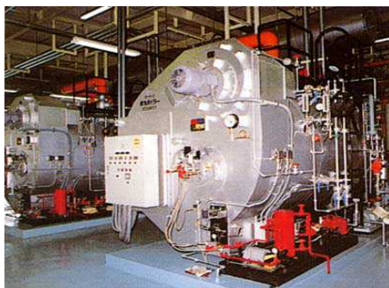
従来型炉筒煙管ボイラ設備
