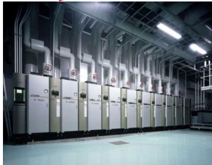
貫流ボイラ多缶設置設備
