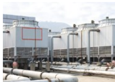
ボイラー・循環水
