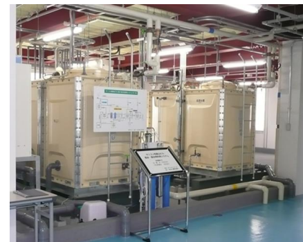
雨水・排水再利用施設(オフィスビル)
