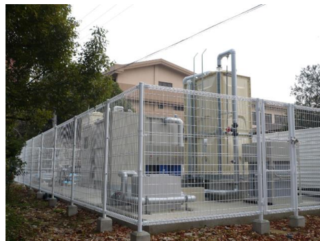
井水浄水施設(病院)
