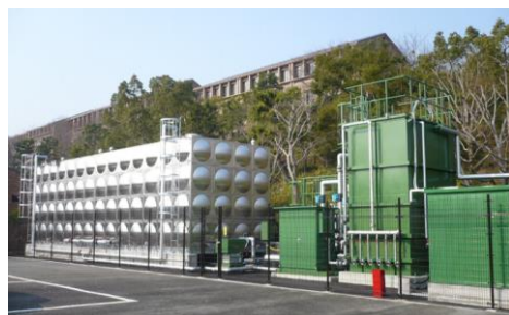
井水浄水施設(大学)
