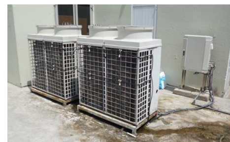
空調省エネシステム(ホテル)
