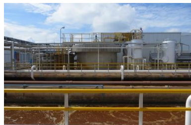
染色工場の排水処理施設(タイ) 処理容量 : 800m 3 /日
