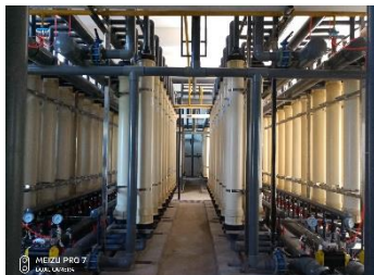
下水処理施設(中国) 処理容量 : 15,000m 3 /日
