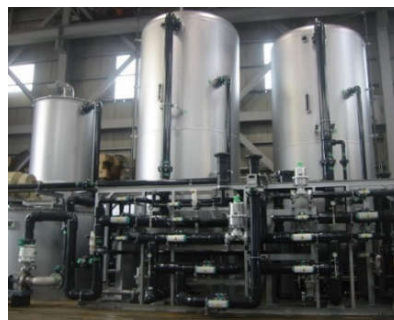
2床3塔式純水装置
