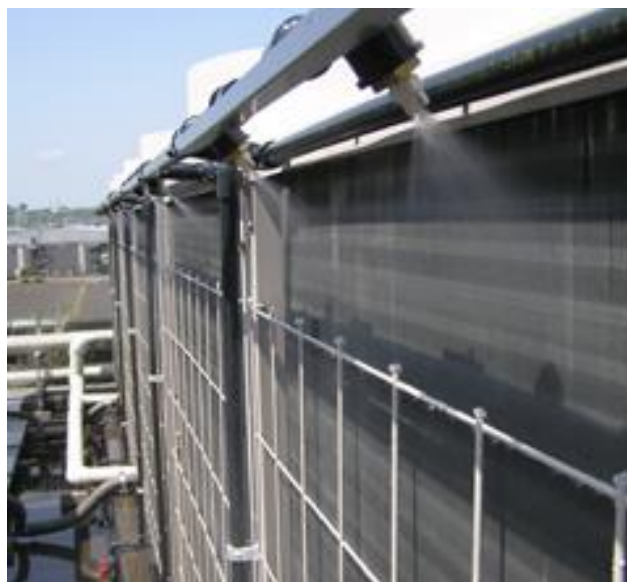
室外機への散水
