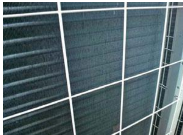
RO水 散水後フィン表面変化なし
