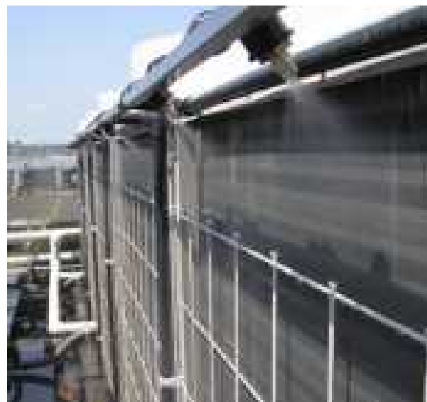
室外機への散水
