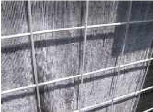
井戸水 散水後スケール付着
