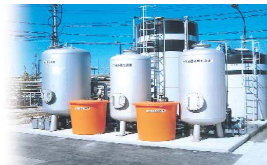
全自動井水処理設備(除鉄ろ過装置＋軟水装置)
