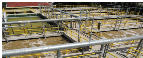
廃水処理設備 好塩菌による高塩濃度廃水処理設備
