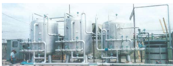
急速ろ過装置＋軟水処理(河川水処理)
