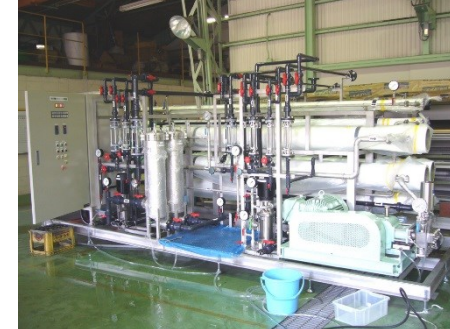
海洋深層水脱塩RO設備 50m 3 /day 海水の純水(RO水)と濃縮水の分離
