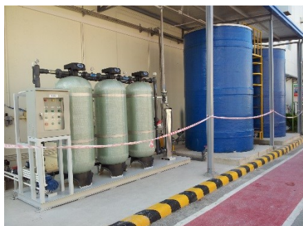
除鉄除マンガン水処理設備 6000L/h 製造工程用(日系ベトナム工場)
